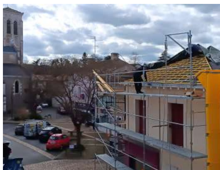
Travaux de couverture sur les locaux commerciaux place de l'Eglise et Cours du Gros Paillet : 26 976,77 €
